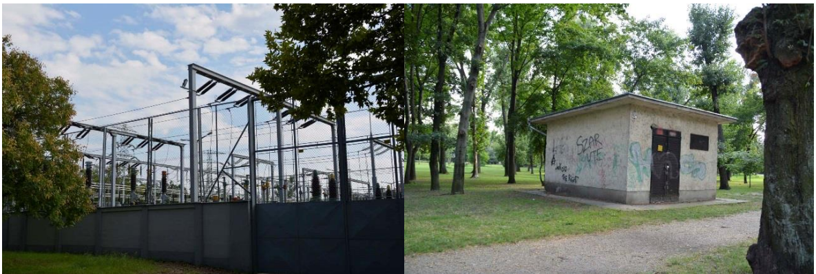
Népliget 120/10 kV alállomás
